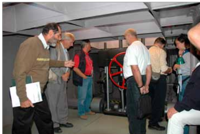
György Akos mit der Gruppe im Kesselraum, man sieht die geringe Raumhöhe.
