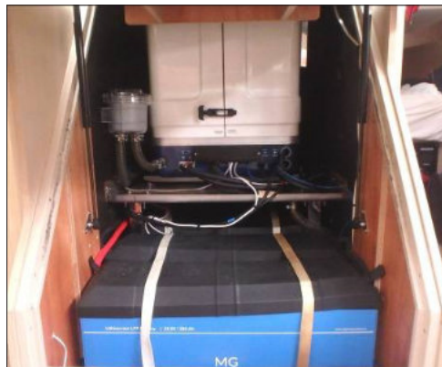
Der Technikraum wird von Akkus und dem Dieselsegenerator dominiert. Der E-Motor befindet sich – gut verborgen – unter den Akkus.
